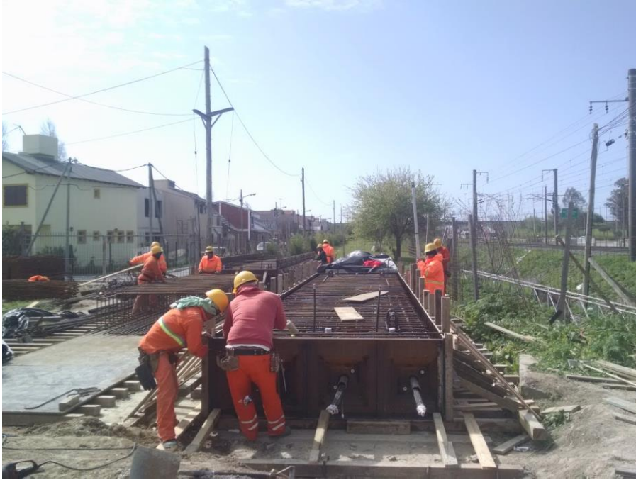
Figura 14: Armado de Viga de puente ferroviario. Se colocan las vainas con cables de pretensado.
