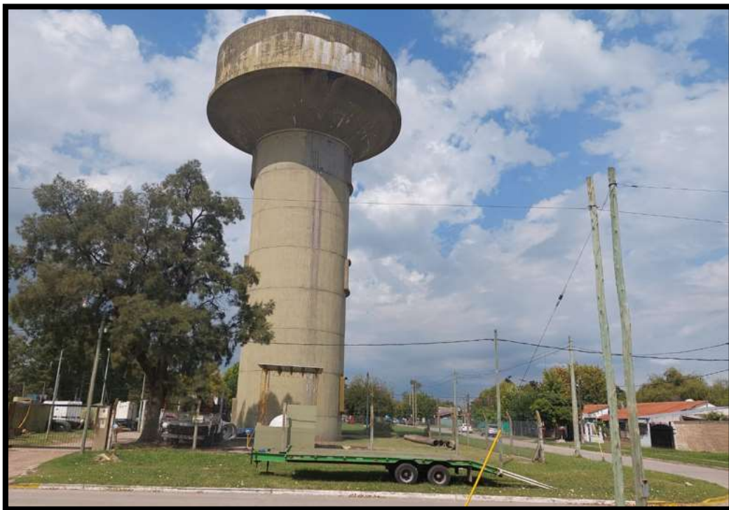
Figura 73 – Cisterna y estación de bombeo existente, Establecimiento ABSA San Vicente.
