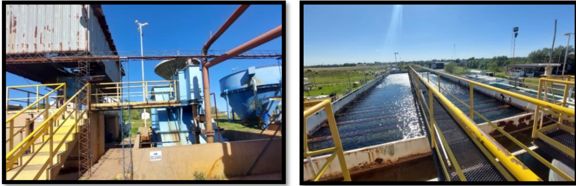
Figura 68 – Planta Potabilizadora de Agua de Carlos Casares
